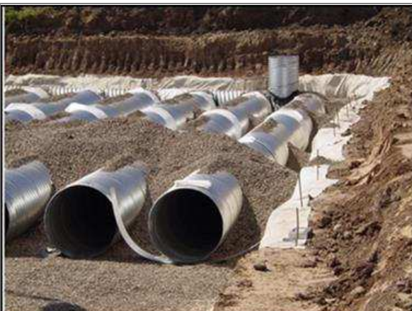
Exemple de bassin enterré de type TuboSider (Source : TuboSider)
